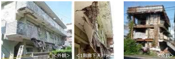
2階の廊下部分が崩落した事例
