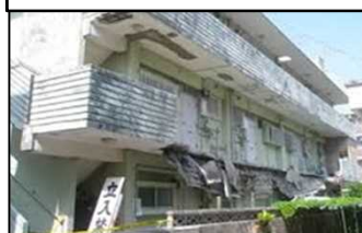
A市のマンション外廊下落下部分
