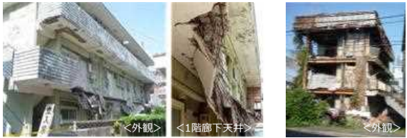
2階の廊下部分が崩落した事例 外壁が崩壊等した事例
