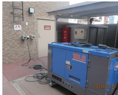
非常用発電機から防災備蓄倉庫へ給電
