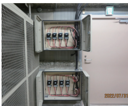
エレベータ電源切替器
