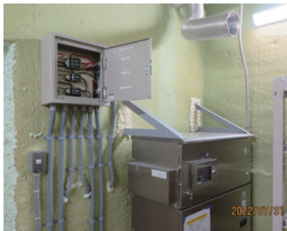
増圧ポンプと電源切替盤
