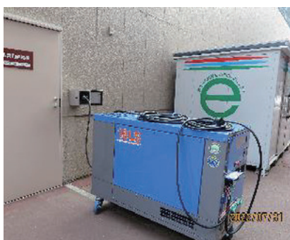
非常用発電機からエレベータへ給電
