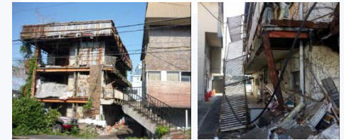
※管理不全マンションの事例（R2、行政代執行により除却）
